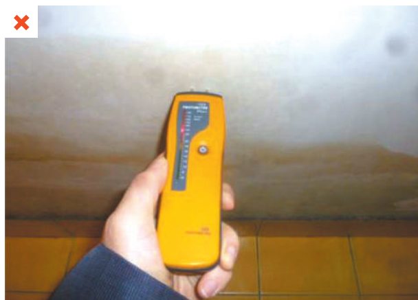
Humidité importante en pied de mur du fait d'une fuite de canalisation. ©AQC-2016
