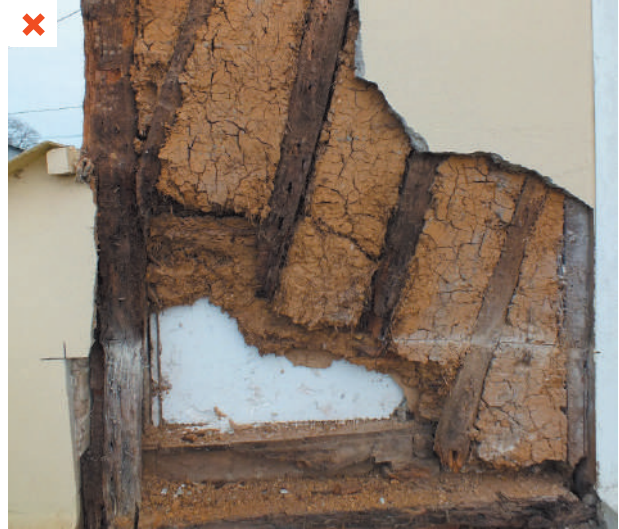
Pan de bois dégradé : le polystyrène côté intérieur a bloqué le séchage du mur vers l'intérieur. ©CoDEM
