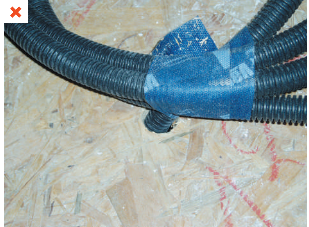
Perçement du plan d'étanchéité à l'air non rebouché. ©AQC-2016
