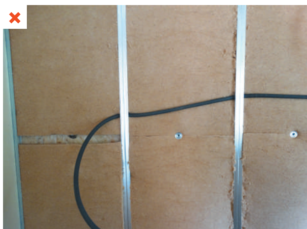
Ponts thermiques au niveau de l'ossature métallique traversante et des jonctions entre panneaux d'isolant (photo prise avant la pose du parement intérieur). ©AQC-2016
