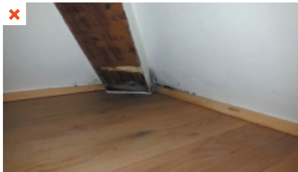
Moisissures dues à un pont thermique poteau/arbalétrier. ©AQC-2016
