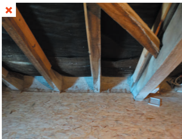
Platelage en OSB d'un plancher haut, situé du côté extérieur de l'isolation, et jointoyé. ©AQC-2016
