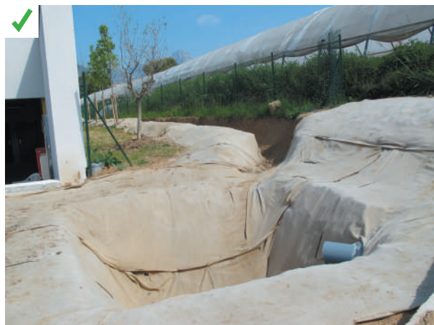
Système de récupération des eaux suite à une inondation due au ruissellement. ©AQC-2016
