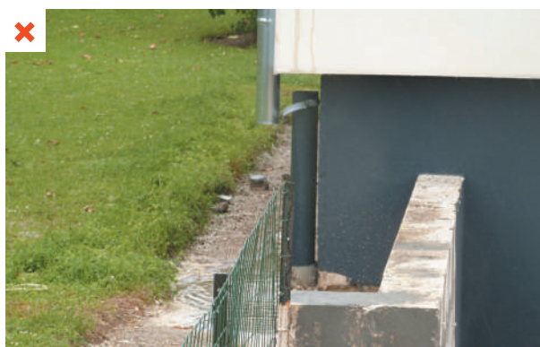
Descente d'eaux pluviales non raccordée à l'évacuation, du fait d'un décalage causé par la pose de l'ITE. ©AQC-2016
