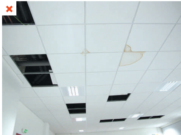
Dégradation du faux-plafond provenant d'une mauvaise jonction entre canalisations existantes et neuves, qui a entraîné une fuite. ©AQC-2016
