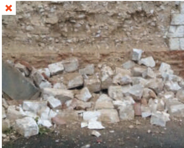
Effondrement d'un mur sur la moitié extérieure de son épaisseur, dû à une concentration trop importante d'eau liée à des infiltrations derrière un enduit ciment. ©AQC-2016
