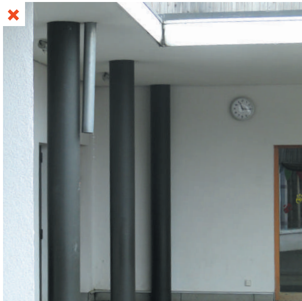
Descente d'eaux pluviales sans évacuation. ©AQC-2016
