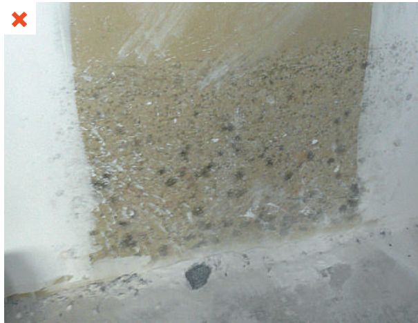
Apparition de moisissures en pied de mur, du fait d'une humidité trop importante au cours du chantier. ©AQC-2016
