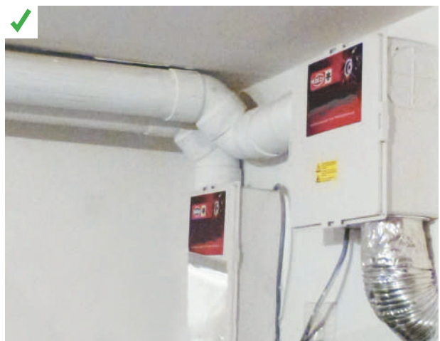
Système de ventilation forcée d'une lame d'air entre l'isolation thermique et le mur humide, permettant d'évacuer l'humidité excédentaire. ©AQC-2016
