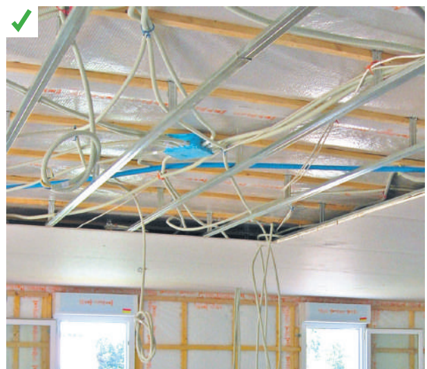
Étanchéité à l'air parfaitement réalisée, présence d'un véritable vide technique, tous les réseaux circulent à l'intérieur du volume étanche à l'air. ©AQC-2016
