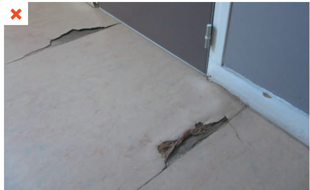
Linoléum qui a cloqué puis s'est percé suite à l'accumulation d'eau en sous-face. ©AQC-2016
