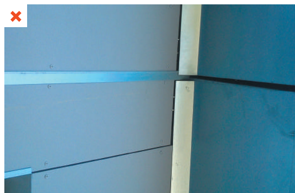
Défaut de calepinage du bardage responsable d'infiltrations. ©AQC-2016
