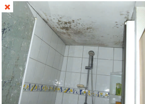
Moisissures liées à un renouvellement d'air insuffisant. ©AQC-2016
