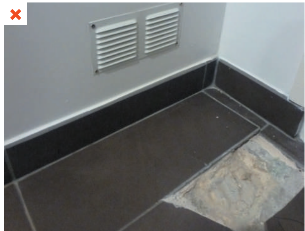
Accentuation de l'humidité dans le sol suite au doublage des murs qui a favorisé les remontées capillaires en empêchant le mur de sécher : il en a résulté un décollement du carrelage. ©AQC-2016
