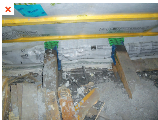
Phénomène de condensation au niveau des têtes de solives, renforcé par l'absence de ventilation de chantier. ©AQC-2016
