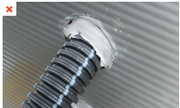
Utilisation d'un produit inadapté à l'étanchéité à l'air, ne comblant pas totalement le perçement et non durable dans le temps. ©AQC-2016
