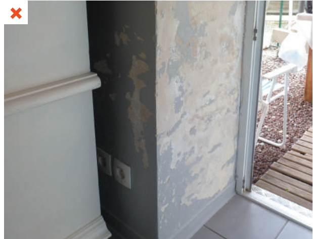
Dégradation des parements et développement de moisissures dues à des remontées capillaires apparues suite à la pose d'un film étanche sous le plancher bas. ©AQC-2016
