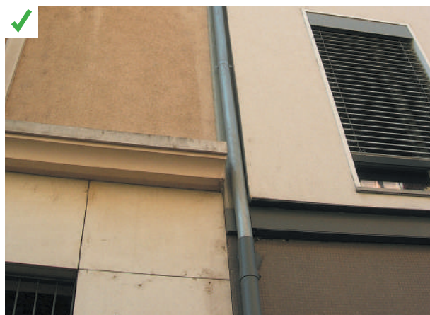
Descente d'eau pluviale non encastrée dans le complexe isolant (ITE). ©AQC-2016
