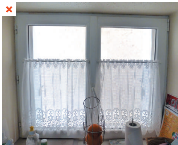
Absence d'entrées d'air - sensation d'humidité très importante dans le logement. ©AQC-2016
