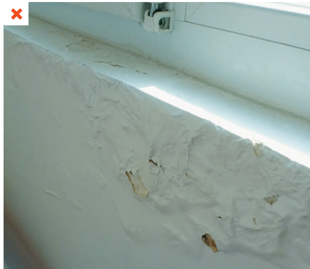
Dégradation des parements du fait de percements de châssis de fenêtres non rebouchés. ©AQC-2016
